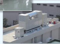
非常用発電設備
