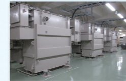
特高受変電設備
