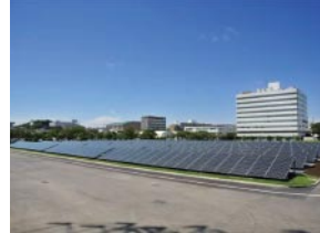
352kWシステム (単結晶太陽電池モジュール 1,760枚を設置)
