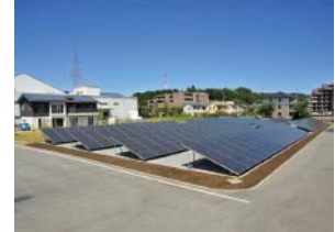
136kWシステム (単結晶太陽電池モジュール 680枚を設置)
