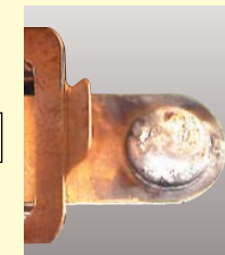
劣化による破損
