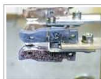
ジャンクション部の過熱・溶損
