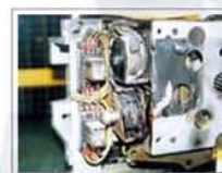
引外しコイル焼損
