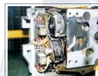
引外しコイル焼損
