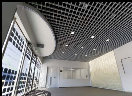
エントランスホール ルーパ天井内に特注ダウンライトを設置し、建築空間と一体化した照明計画を行っています。
