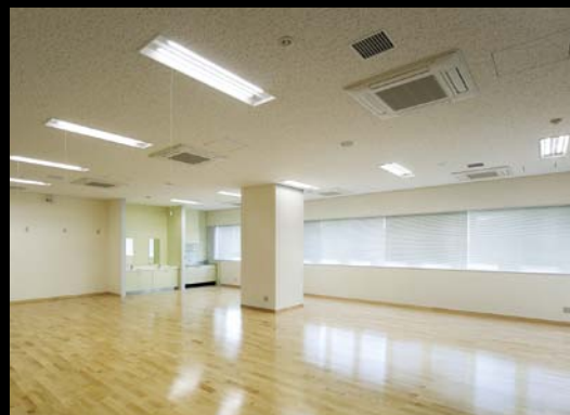
社員食堂 LED器具一体形埋込下面開放器具を設置。器具にはプルスイッチが取り付けられ(特注)、こまめな点滅によって省エネを図ります。
