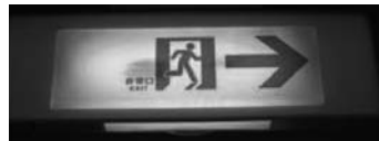
劣化した表示板の例
