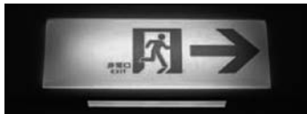
正常な表示板
