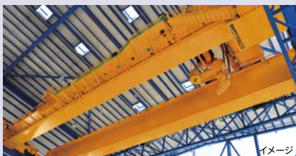
屋外クレーン
