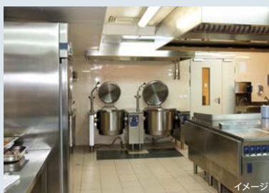
レストラン厨房(高温用ライトユニット)
