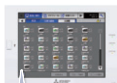
コンデンシングユニットの運転データはAE-200Jが記録・収集
