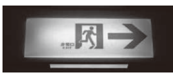
正常な表示板
