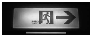
正常な表示板
