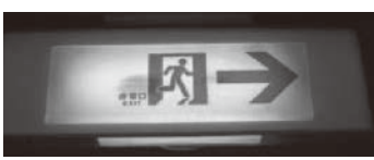
劣化した表示板の例
