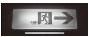
正常な表示板
