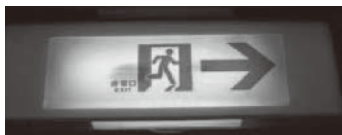
劣化した表示板の例
