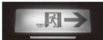
正常な表示板
