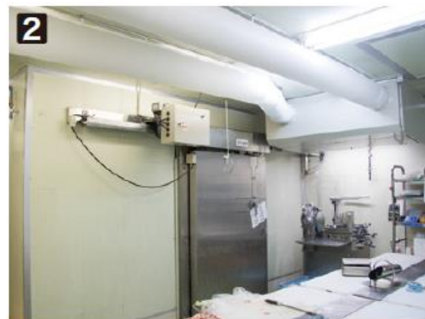
② 整形室のソックダクトは全長約4m
