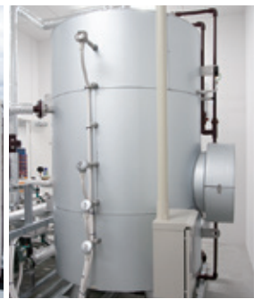
▲貯湯槽は密閉型で呼称容量2トン(有効貯湯量2.117m 3 )。別室にあり、温水配管は天井を通して。
