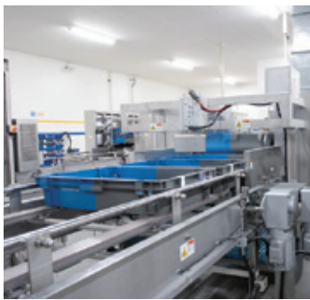
▲1枚ずつコンベアで洗浄機に。約60℃の温水で洗浄した後、遠心脱水工程へ。
