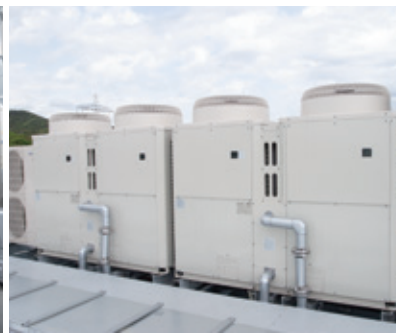
▲洗浄用温水の熱源機は三菱電機のホットウォーターヒートポンプ。センターの屋根上に設置。
