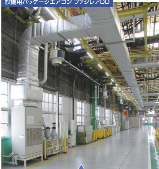
第10機械工場生産ラインのダクト空調として採用された、設備用パッケージエアコン「ファシリアDD」
