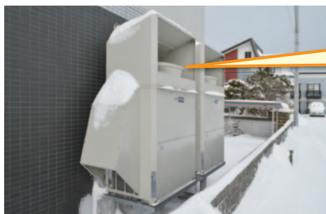
▲室外ユニット
