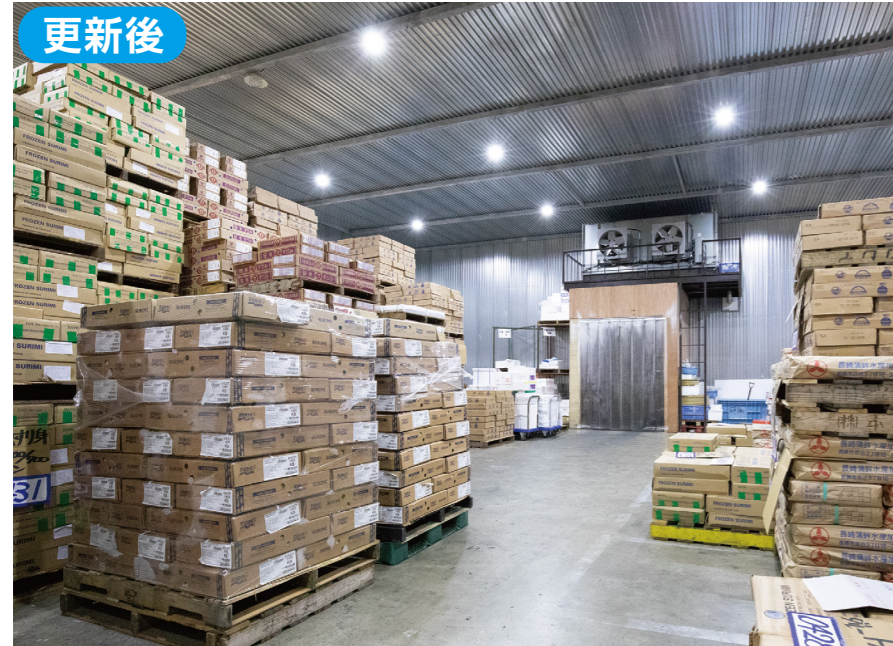
▲冷凍水産物を保管する第2倉庫冷凍庫。設備更新後は着氷がほとんどなくなった。冷却器はホットガスデフロスト方式で、吹出し側・吸込み側ともダンパ仕様とし、除霜時の庫内温度上昇を抑制
