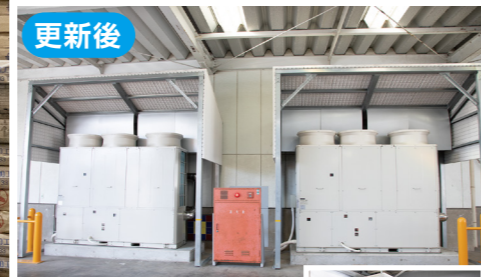
更新後 ▲第2倉庫冷凍庫の前に設置されたAFSV形クーリングユニットの熱源機。耐重塩害仕様
