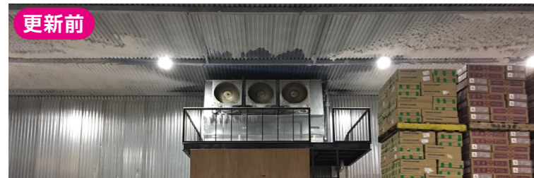
▲更新前の庫内は冷却器の経年劣化や散水デフロストの影響などで着氷が多かった。氷片が落下するため床面にも注意が必要だった
