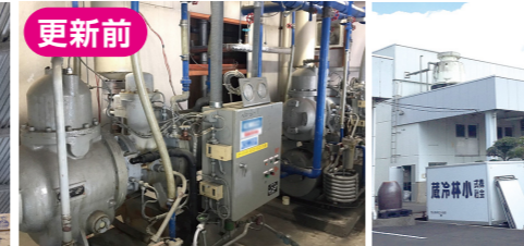
更新前 ▲一定速・R22水冷スクリーン冷凍機24kW×2(他社製) ▲冷却塔のメンテナンスも大変だった
