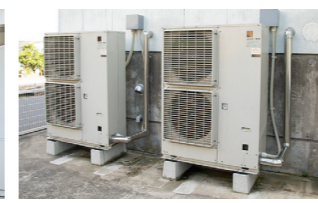
▲第2倉庫鮮魚冷蔵庫の熱源機。R22一定速機からR410Aインバータ機に更新した
