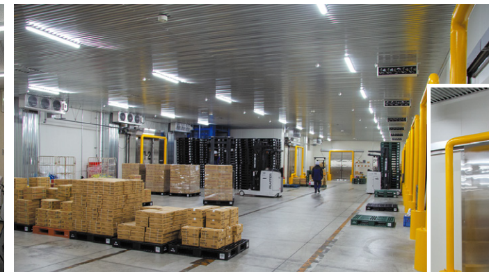
▲荷捌室の温度は5℃設定。結露対策に三菱電機製エア搬送ファンを導入 ▶扉に設けられた小窓は、内と外、それぞれの様子がうかがえるとスタッフに好評
