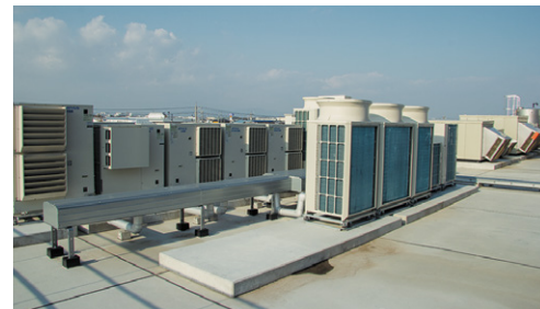
▲コンデンシングユニットは屋上と工場脇の2ヶ所に集中設置(写真は屋上)
