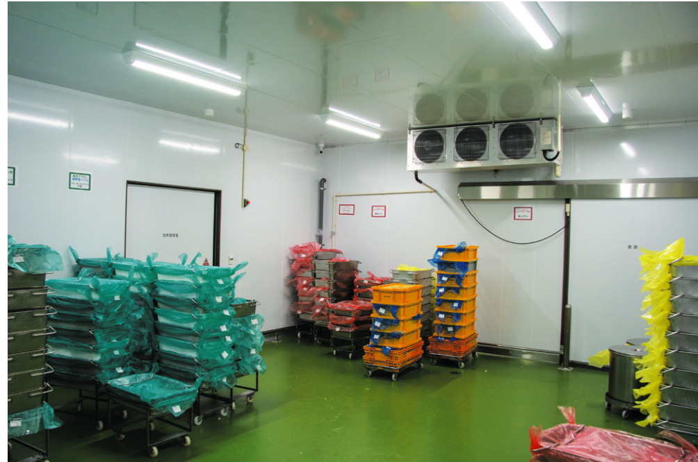
▲塩分濃度の高い半製品冷蔵庫には腐食に強い熱交換器配管厚肉仕様のユニットクーラを採用
