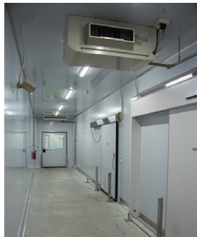
▲冷蔵庫や冷凍庫に接する通路には産業用除湿機を設置し、ドアの開閉時の冷気流入による結露発生を防止
