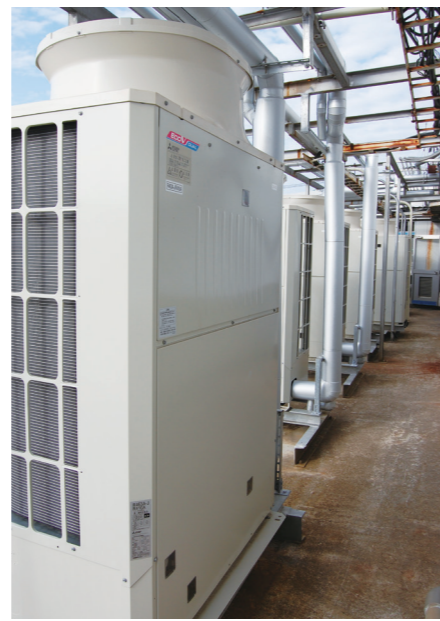
▲2号庫・3号庫に3台ずつ採用されたR463A-J/R410A兼用仕様のECO V-D75MAは、アルミ扁平管熱交換器を採用し、放熱性能が向上
