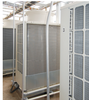
▲1号庫用のECO V-EN75MC1×4台を含め、コンデンシングユニット全10台は、第1冷蔵倉庫の外壁脇に集中設置
