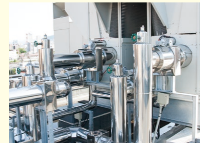
▲丁寧な仕上げの配管接続
