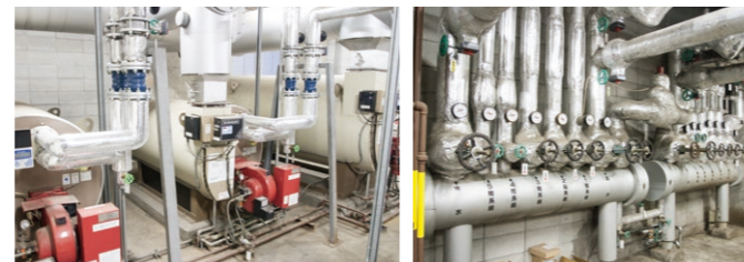
▲機械室の温水ヒーター(バコティンヒーター)。3台のうち右の1台は融雪用
