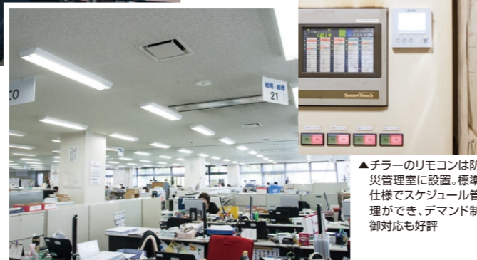
▲基準階のオフィス内。ファンコイルユニット(2方向吹出し)が均等に配置されている
