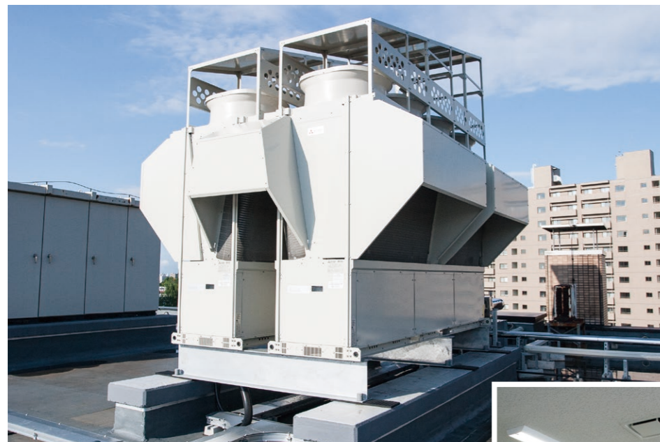
▲屋上に設置された空冷ヒートポンプチャラーDT-R(60馬力×2台)。積雪対策として防雪フード(ヤブシタ製)を装着
