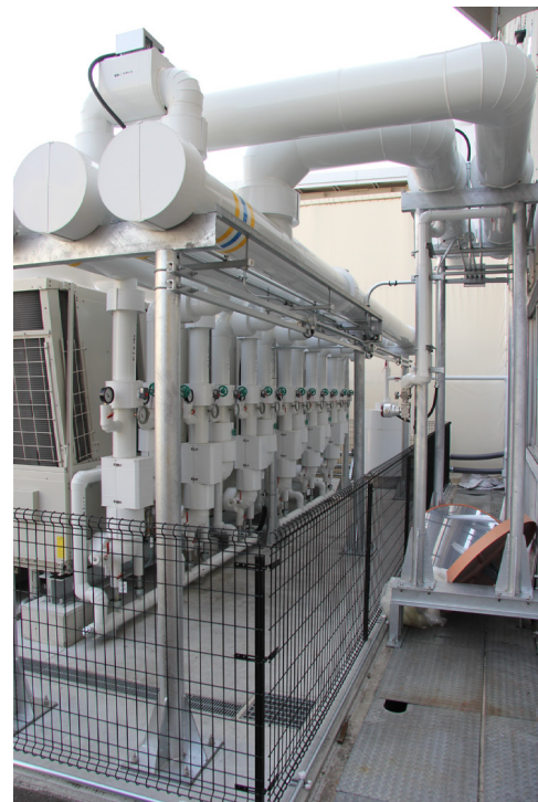
▲ユニットごとに台数制御ができるポンプ内蔵タイプを採用して、省エネを促進。さらに施工の手間も軽減
