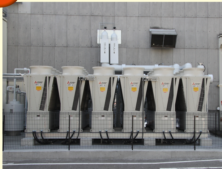
▲GWP(地球温暖化係数)がR410A冷媒の約1/3であるR32冷媒を採用した空冷式ヒートポンプチラーDT-RⅢ
