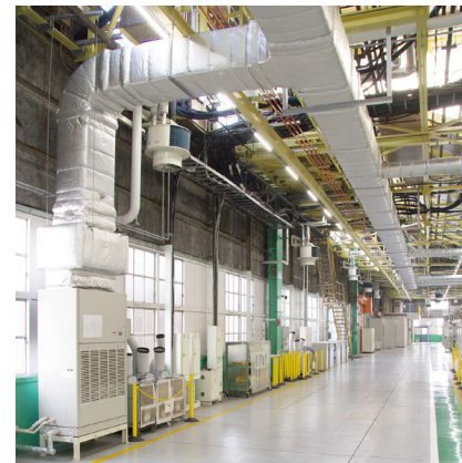
▲2019年10月、第10機械工場生産ラインの空調機として採用された、設備用パッケージエアコン ファシリアDD。冷気はチャンバーを介してダクトで作業エリアに供給
