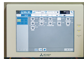
▲空調と給湯を一括管理できる空調冷熱総合管理システムAE-200Jは事務室に設置
