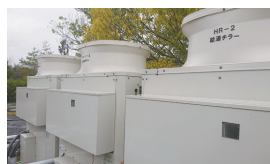
▲給湯用の業務用エコキュート
