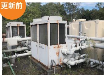
▲空調と給湯を両方担っていた既設チラー(CAH-20FLQ2)など、集中設置された熱源機群
