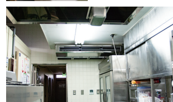
▲厨房用エアコンも採用された(補助金対象外)
