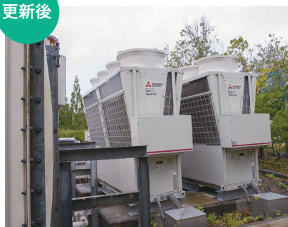
▲セントラル部分の空調を担う空冷式ヒートポンプチラー DT-R11
