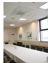
◀コンペルームや事務室などはマルチエアコンで空調
