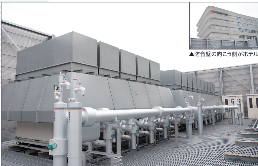
▲DT-RIIIは60HP相当機15台が採用された。5モジュール連結で新館7階部分に設置。ホテル客室が近い ため、防音フード・防音チャンパー付
