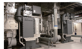
▲吸収式冷温水機
