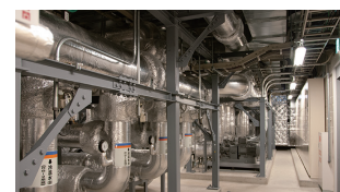
▲機械室に並ぶヘッダーとポンプ
