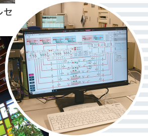
▲新館内の防災センターで空調の運転状況をモニタリング。システムの制御は西部ガステクノソリューション長崎事業所様で実施
