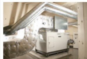
▲機械室にあるエアハンドリングユニット(エントランス系統)
