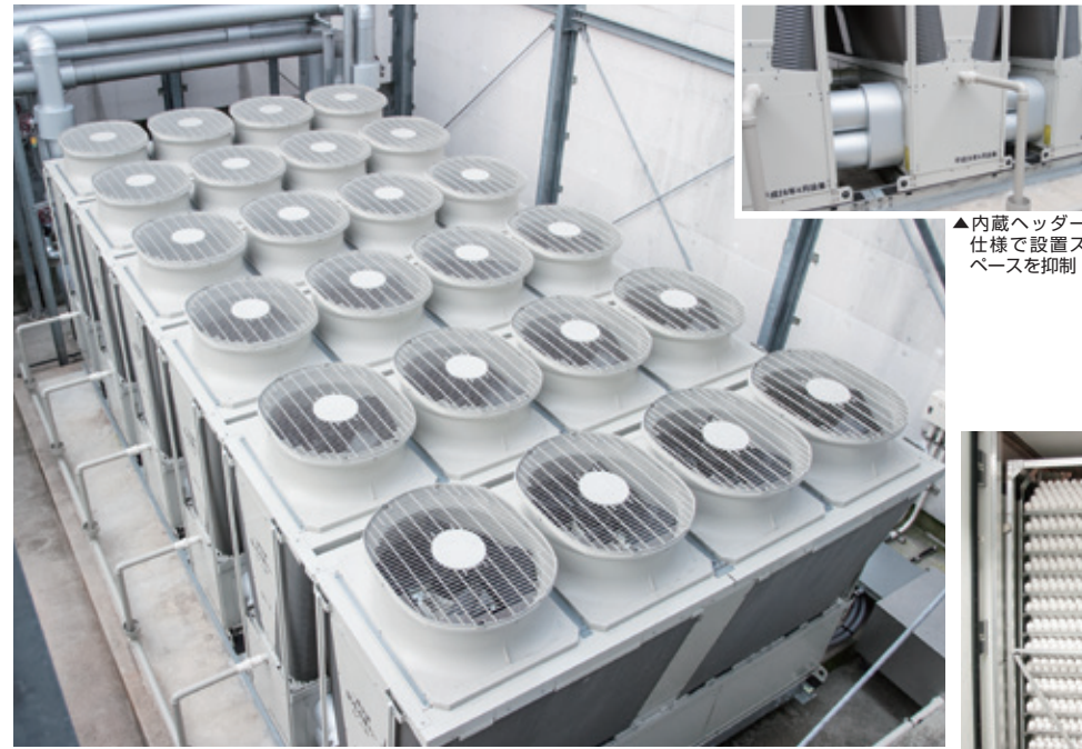
▲空冷チラーDT-R(冷房専用)。内蔵ヘッダー仕様で50馬力機6台をコンパクトに集約設置
