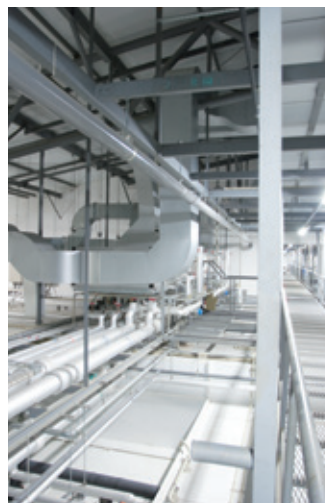
▲衛生管理が厳しい場内は、小屋裏(2階相当)まで清潔。空調機(AHU)等が設置され、機械室となっている
