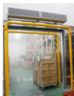
▲エアーカーテンも三菱電機製。奥は-30℃の冷蔵庫
