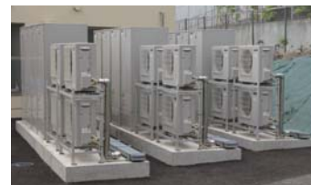
エコキュート設置写真(4～15)
