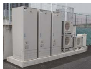
エコキュート設置写真(1～3)
