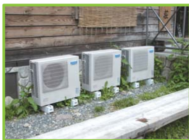
▼ ヒートポンプユニット設置場所
