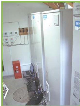
▲ 貯湯タンクユニット設置場所
