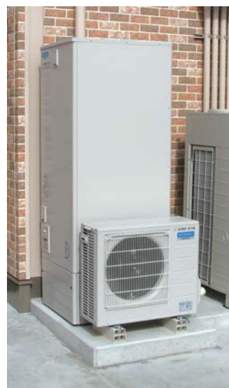
エコキュート 設置写真
