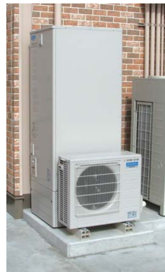
エコキュート 設置写真
