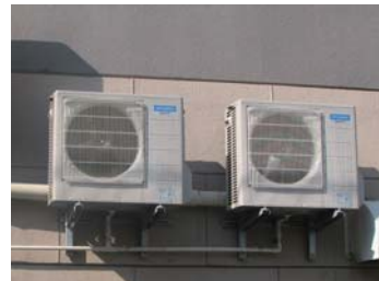
ヒートポンプユニット
