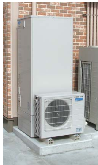
エコキュート 設置写真
