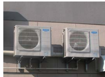
ヒートポンプユニット
