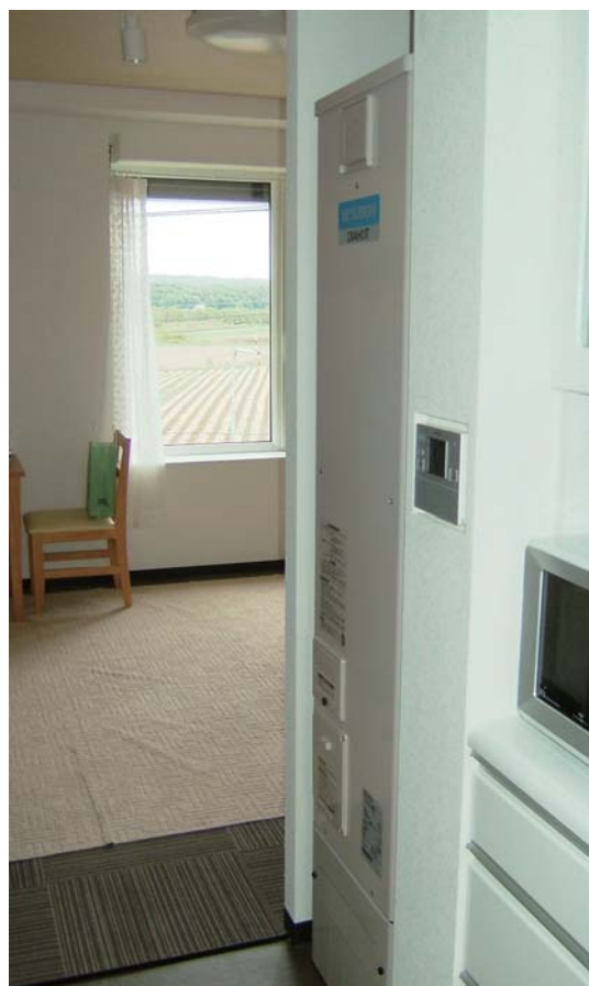
①貯湯ユニット設置写真
