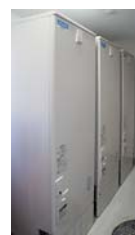
ヒートポンプユニット
