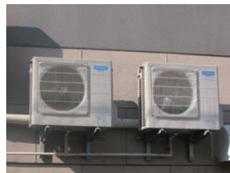
ヒートポンプユニット
