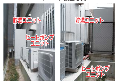
エコキュート設置写真
