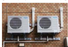
《ヒートポンプユニット》
