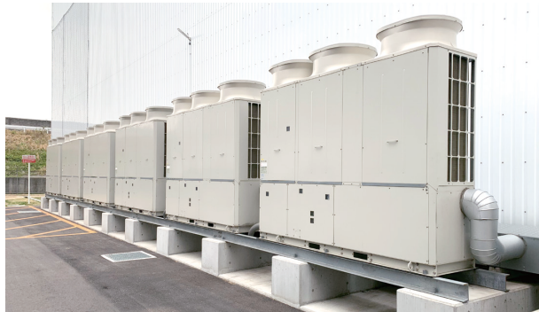
◀ラック倉庫の東側外壁に沿ってAFSV形クーリングユニットの熱源機を設置。大阪湾が近いので、熱交換器は「プライゴールド」耐塩塗装仕様(アイテック株式会社による施工)
