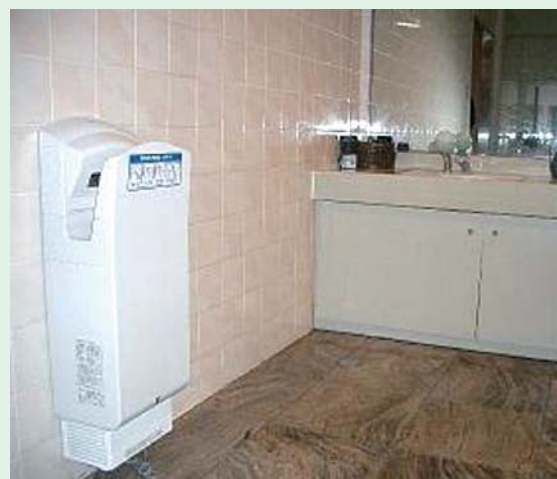
▲男性用と女性用トイレ(写真)にNEWスリムタイプ各1台を設置。
