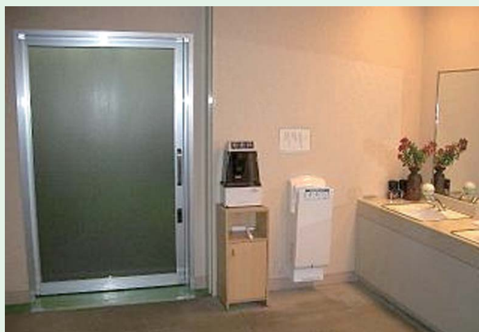
▲衛生管理のため工場入り口手洗いにもNEWスリムタイプを設置。
