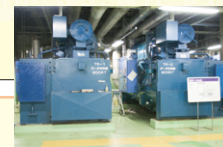
②1998年の竣工時からあるターボ冷凍機800Rt×2
