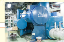
③2001年に追加設置されたターボ冷凍機(1,100Rt)
