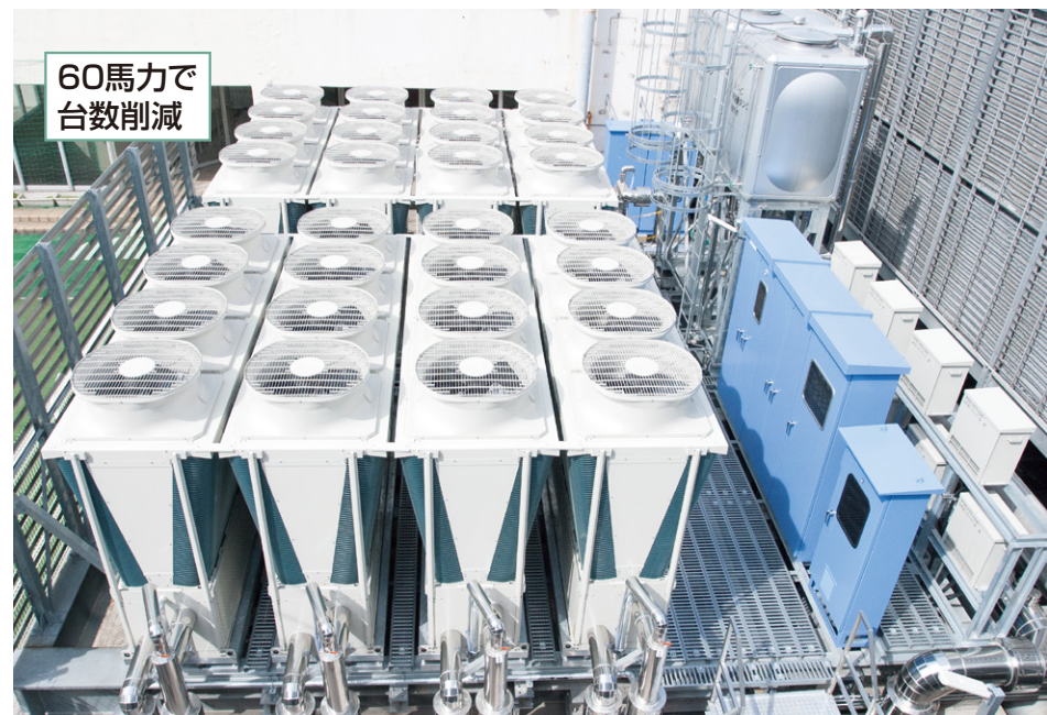
▲ビル屋上に架台を組み、同一平面に180kWモジュール8台を集約設置。更新前はここに氷蓄熱槽があった。
