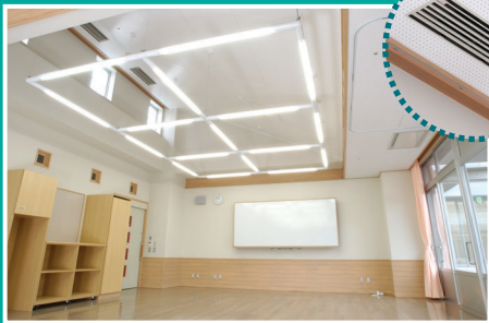
斜め天井の最上部(フラット面)にエアースイングファン2台が設置されている。
