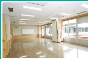
フラット天井の教室にもエアースイングファンが採用され、暖房効率を改善している。
