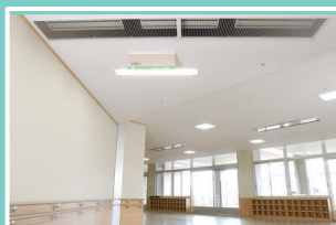
各ブロックの境目の廊下天井にはエアーカーテンが埋込まれ、バリアフリー化を実現している。
