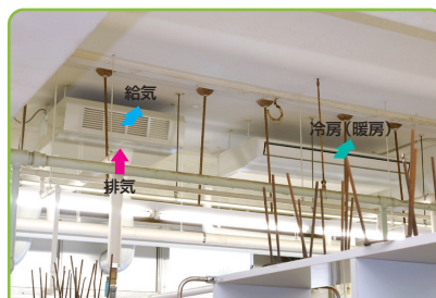
1階の一般科学実験室には、天吊形の学校用ロスナイが設置されています。
