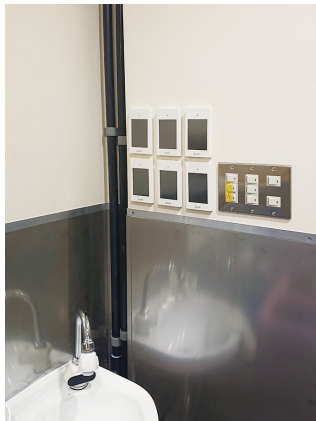
▲コントローラは厨房内に集中設置
