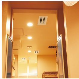
▲厨房天井の吹出口。本体は天井埋込形
