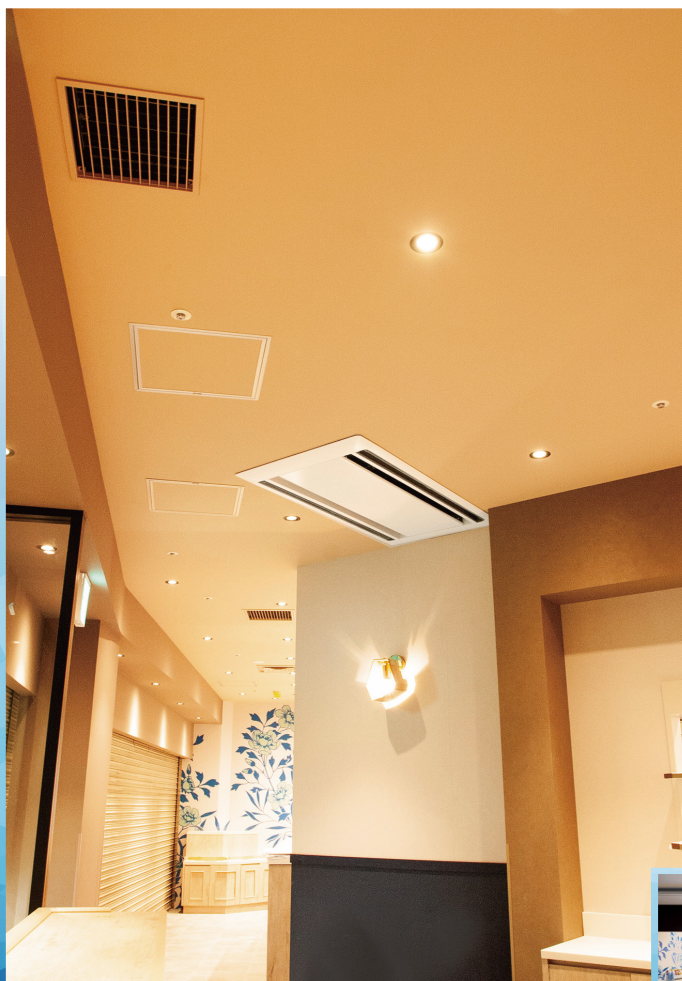
▲お店は地下街「ホワイティうめだ」の「ノースモール1」にある。客席冷房用の天井カセット形は全部で4台あり、1台は入口そばに設置。黒いグリル状のものは天井埋込形(カウンター内冷房用)の吸込口
