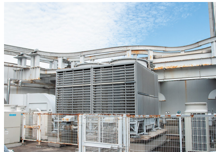
▲ビル用マルチエアコンを水冷式から空冷式に更新することで冷却塔の容量不足は解消した。冷却塔とポンプは2台ある
