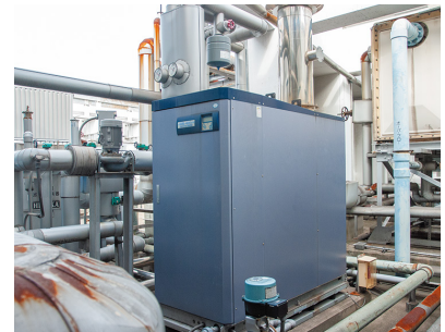
▲暖房用の補助ボイラー(パコティンヒーター)
