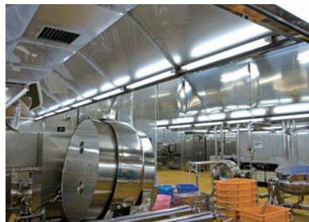
▲加熱調理室は外調機からの給気とファンによる排気で熱負荷を制御
