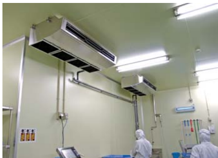
▲プリン製造室の厨房用エアコン。酸性の雰囲気となる部屋は、SUS外装や熱交換器カチオン電着塗装で室内ユニットの防蝕対策をとった
