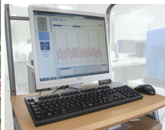
▲事務室のMELCOLD IIで全室の温度を制御。水量などユーティリティの計測値も管理できる
