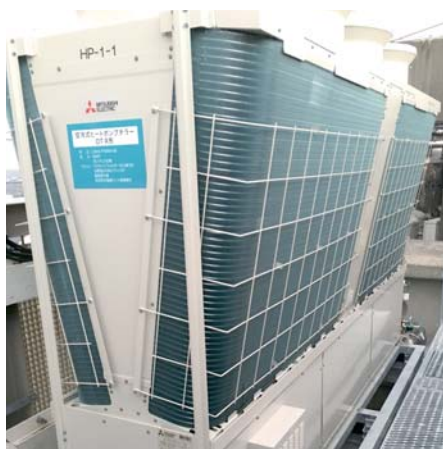
▲ポンプレス仕様の1台。熱交換器の塗装は見学用に耐塩害仕様にした。フィンガードも設置
