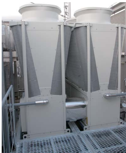
▲150kWモジュール2台連結。内蔵ヘッダー仕様で配管収まりもスッキリ
