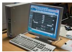
▲空調や給湯などの設備機器はFacimaシステムで管理する
