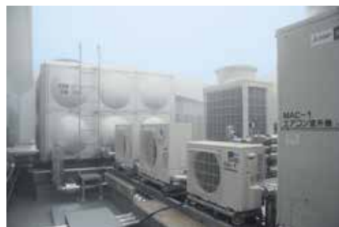
▲貯湯槽(開放型)の手前に並ぶのは空調用室外機
