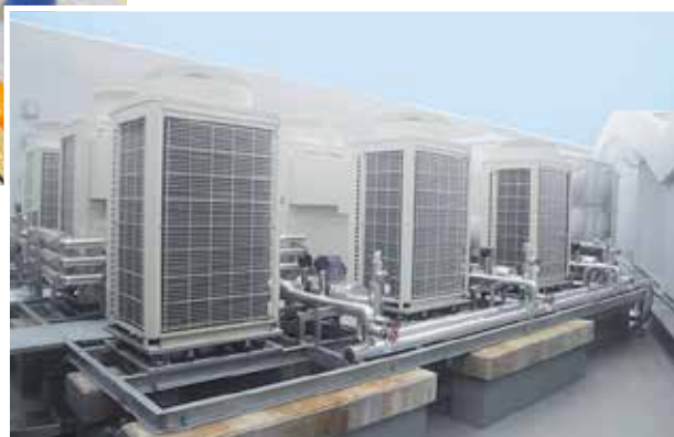
▲屋上に集中設置されたホットウォーターヒートポンプ(手前)と業務用エコキュート(奥)
