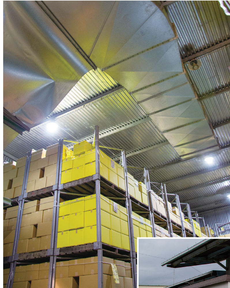
▲ダクトを使用して庫内の温度ムラを軽減
