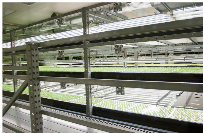
▲見学通路からみる育苗棚。上から下へ吹く空調 airflow を誘引ファンで棚の間に引き込む。天井の太いパイプは二酸化炭素供給用
