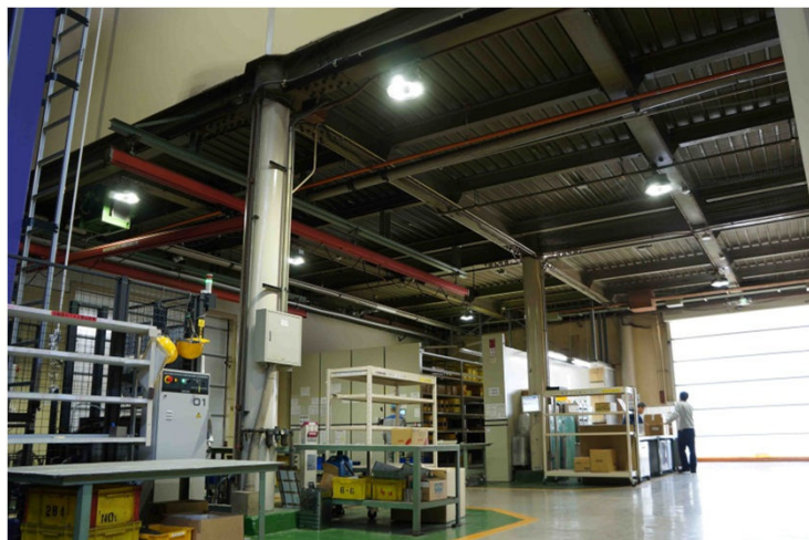
工場内 LED高天井用照明
