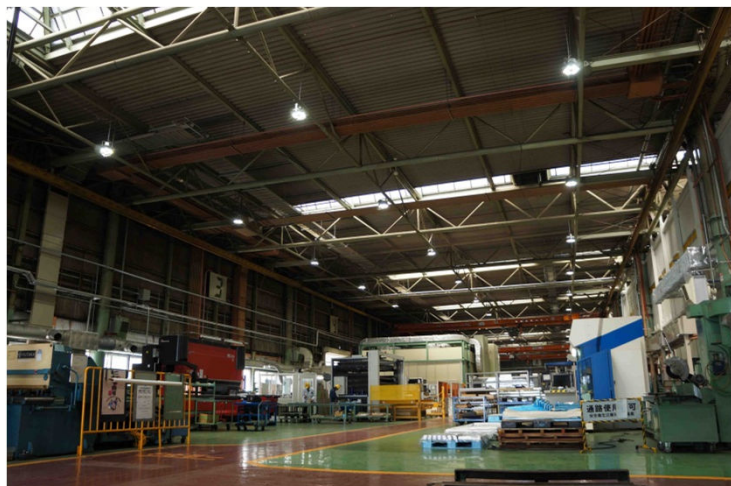
工場内 LED高天井用照明
