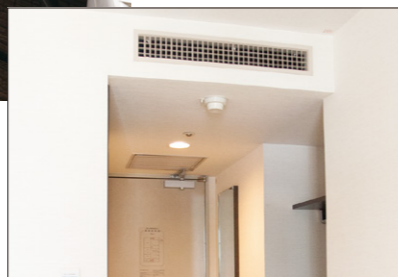
▲シングルルームの空調吹出口。負荷側(ファンコイルユニット)は既設のままだが、空調は快適
