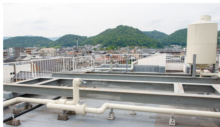
▲ガス式温水ヒーターとガスコージェネシステム、貯湯槽2基を撤去した後のスペースは有効利用を検討中。奥にあるのは膨張タンク
