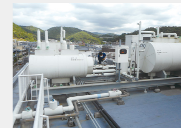
▲既設の貯湯槽は0.5tonと1.5tonの2基
