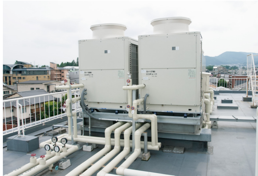
▲入院棟の屋上に設置された業務用エコキュート
