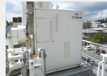
▲2018年に一度更新したガス式温水ヒーター
