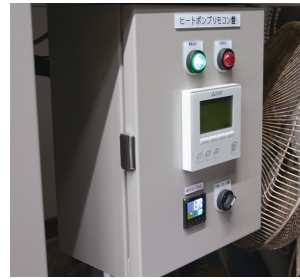
▲制御盤とリモコンは給湯機のそばに設置
